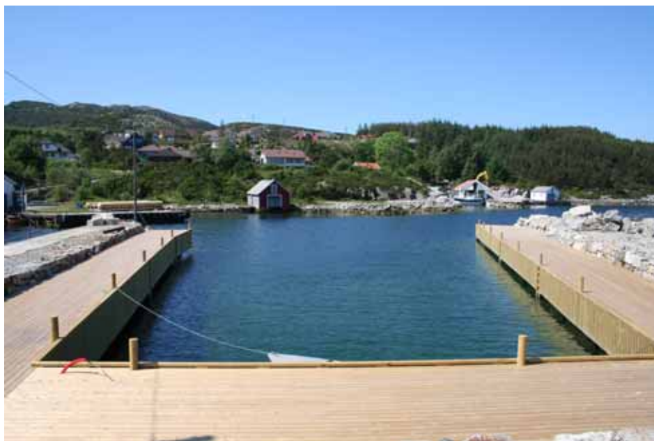
Snekkararbeidet er ferdig. Når tankannlegget for diesel, bensin og vatn kjem på plass, kan første båt leggja til.
