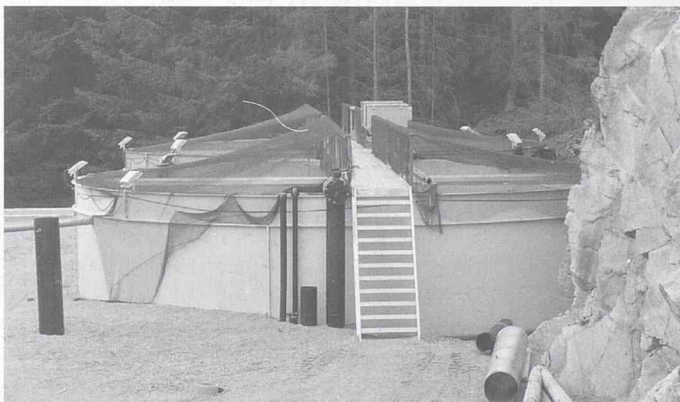
Nye store kar er monterte nord for eksisterande anlegg. Fleire kar vil koma.
